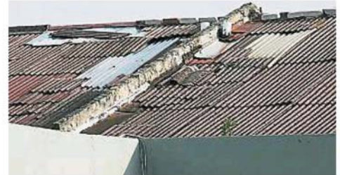
屋頂年久失修，近年來出現漏水問題。
